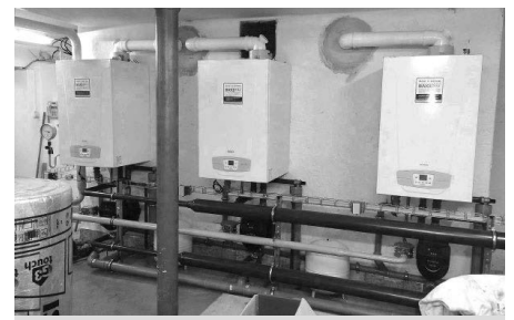
Nové plynové kotle, které budou vytápět budovy Základní školy Velké Pavlovice.
