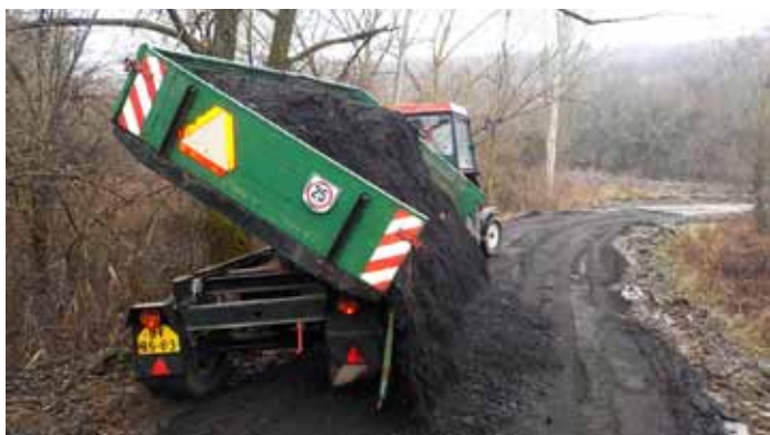
Polní cesta v lokalitě Súdň byl zpevněn. Jako materiál byl použit asfaltový recyklát.
