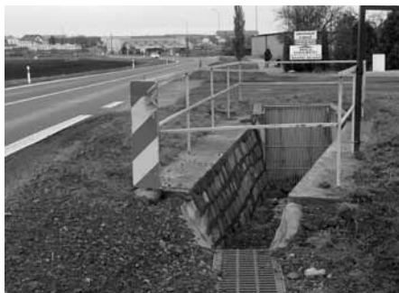
Nebezpečná betonová vstup v bezprostřední blízkosti vozovky od Bořetic brzy zmizí.
