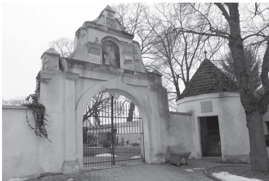
Vstupní brána na velkopavlovický hřbitov je již delší dobu v havarijním stavu.
