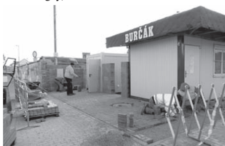
Pokládka zámkové dlažby v prostoru před nově vybudovaným veřejným WC na autobusovém nádraží.
